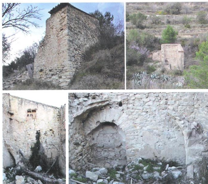
Figs. 2, 3, 4, 5: Edifici del Tros de la Sénia: dalt a l'esquerra, parets exteriors sud-est (façana) i nord-est; dalt a la dreta, vista de l'edifici des de la casa del Tros de la Sénia; baix a l'esquerra, paret interior nord-est (amb porta cegada baix a la dreta); baix a la dreta, paret interior nord-oest (amb l'arrancament de la volta, obertura amb arc de pedra i escala de caragol) (font: l'autor)
