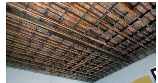
Ilustración 214, Falso techo desprendido
