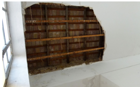
7. Desprendimiento falso techo
