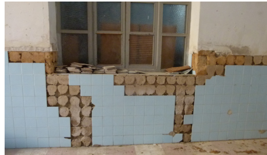
4. Desprendimiento baldosas zócalo
