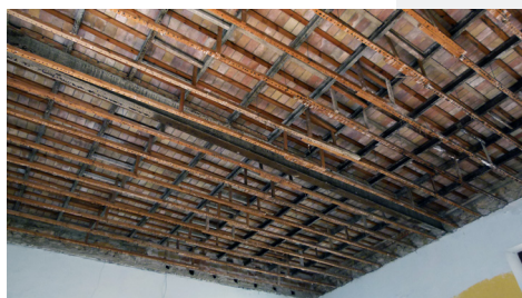
Ilustración 214, Falso techo desprendido
