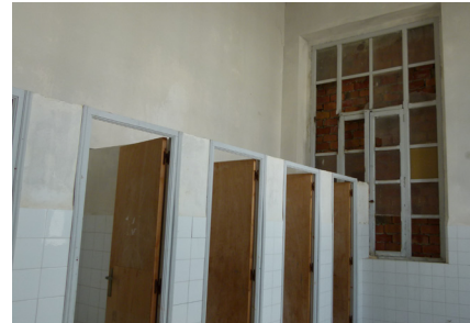
Ilustración 114, Ventana cegada en baño de planta baja
