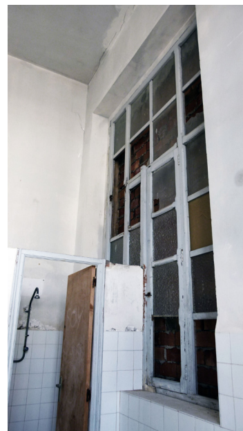
Ilustración 161, Ventana cegada en baño de planta baja
