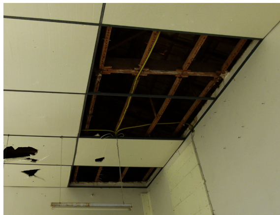
Ilustración 159, Aula de música con recubrimiento de paredes y falso techo con corcho
