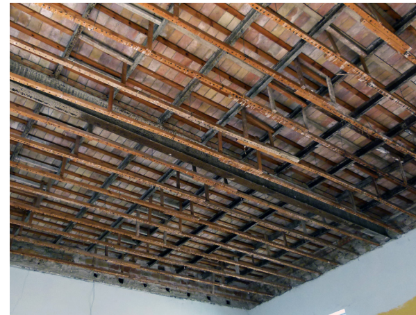
7. Desprendimiento falso techo
