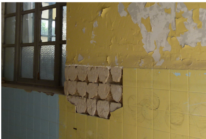
4. Desprendimiento baldosas zócalo
