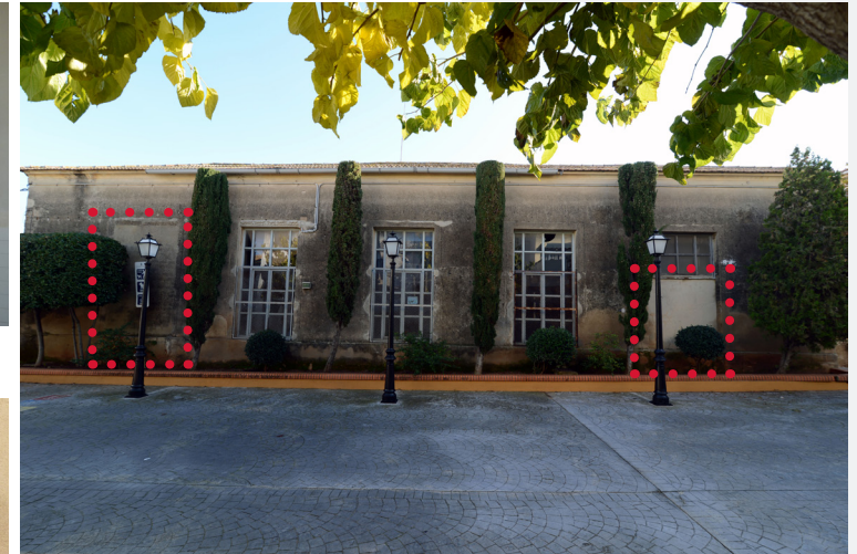
Ilustración 117, Ventanas cegadas en fachada trasera
