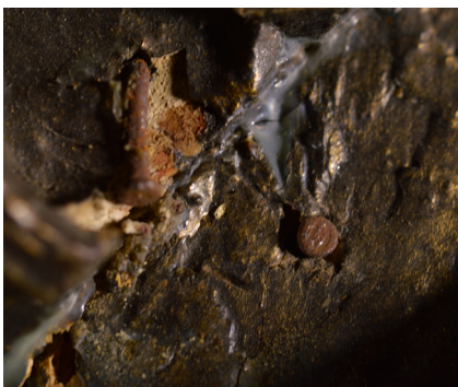
Imagen 56: Detalle de la oxidaci n de los clavos as  como restos de adhesivo.
